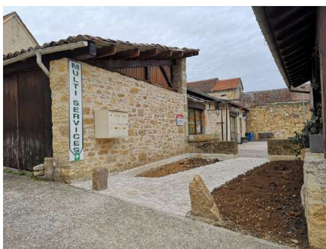
Retrait du marronnier et réfection de la chaussée face à la Petit' Pause
